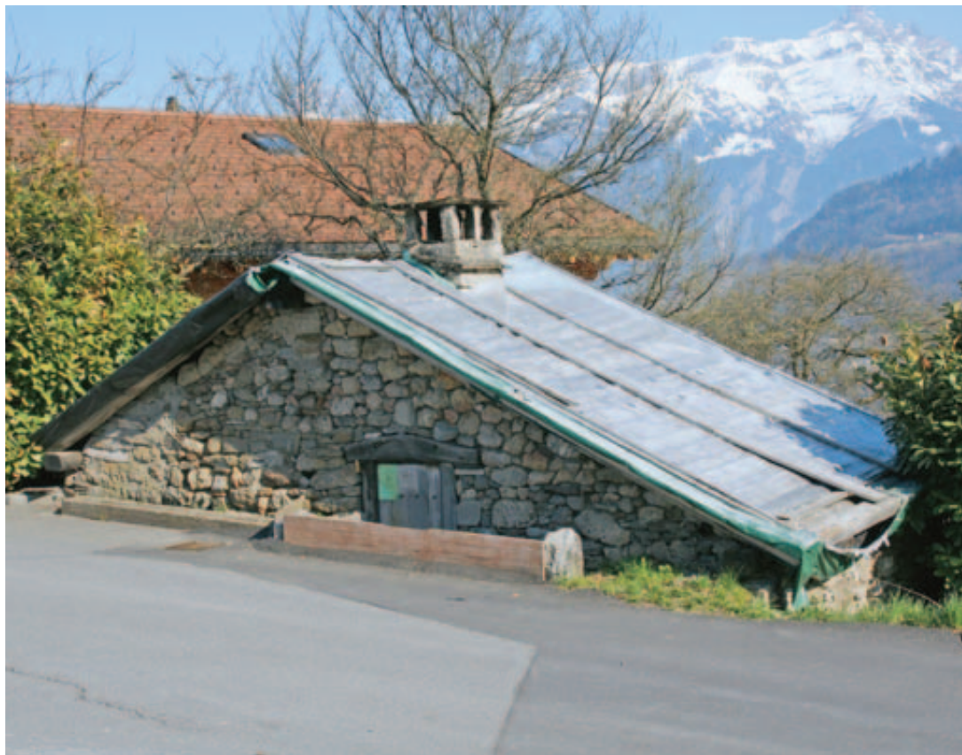
L'édifice qui abrite le four est situé en contrebas de la place de Propéraz. Son toit menaçait de s'effondrer et a dû être démonté et remplacé par une couverture provisoire. DR
